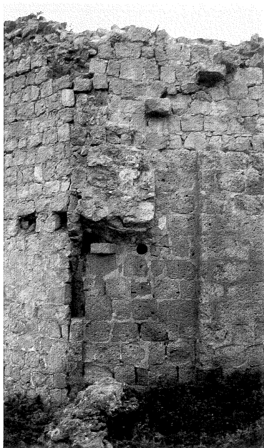
16/ Porta 2: Interno – I resti della porta delle III fase con il cardine. Della V fase sono evidenti i gradini in trachite che conducono al cammino di ronda.
